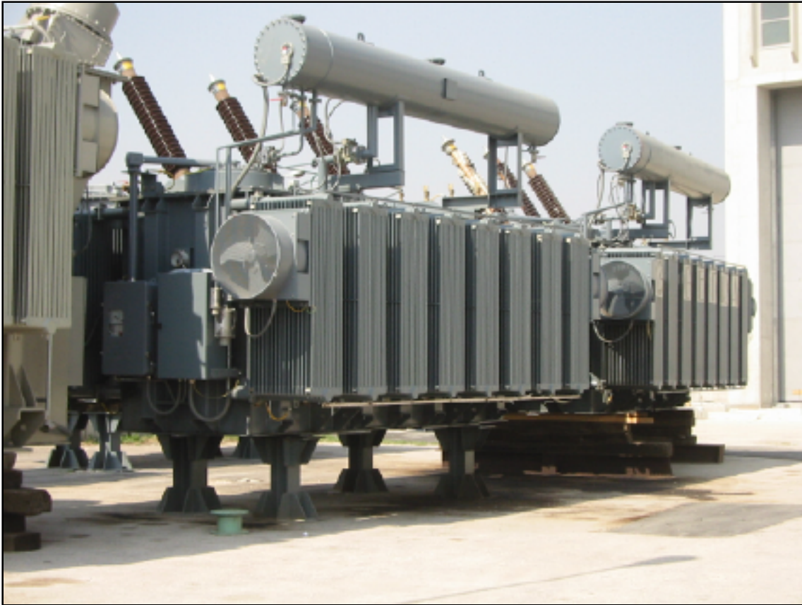
Figura 2.27: raffreddamento in un trasformatore di grossa potenza.
