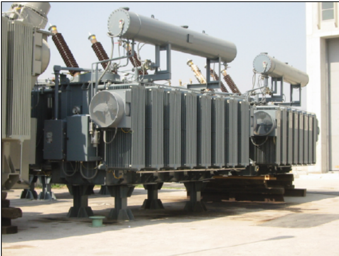
Figura 2.27: raffreddamento in un trasformatore di grossa potenza.
