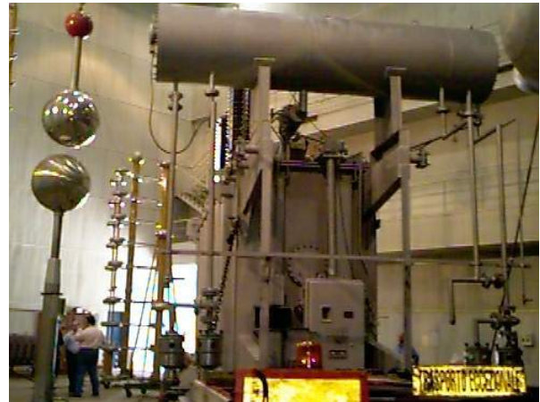
fig. 4 – Prova su trasformatore AT
